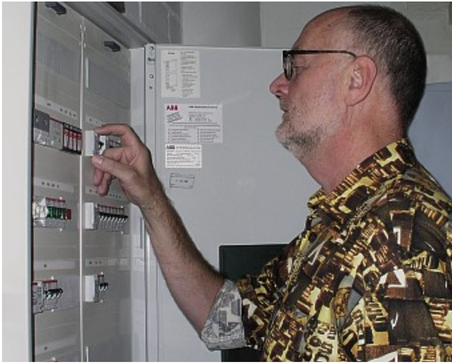
Durch regelmäßige Prüfung stellen Sie sicher, dass FI-Schalter wirksam sind
