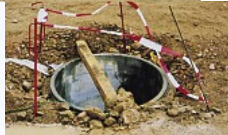
Die Baustelle in Arneburg: genug Ansatzpunkte für die Kampagne zur Vermeidung von Stolper-, Rutsch- und Sturzunfällen
