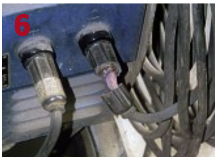
Bild 6: Defekter Leitungsanschluss an einer Schweißstromquelle
