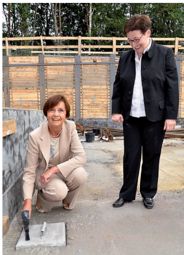
Der Grundstein für das neue Forschungsgebäude des ZOQ ist gelegt. Foto: UHH/PS
