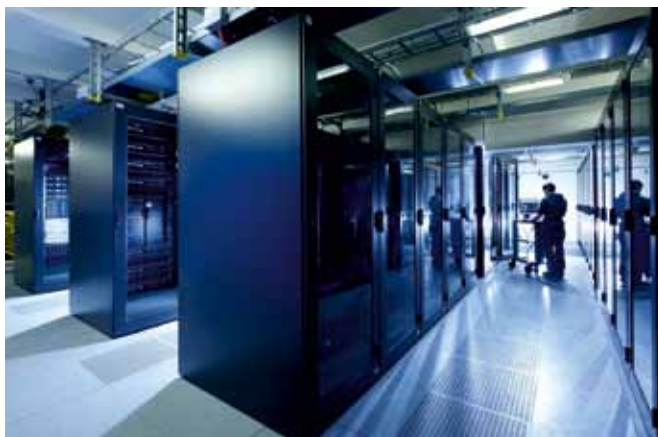
DESYs RZ2 - 3000 Prozessoren, 2000 Terabytes und Hochgeschwindigkeitsnetze für die DESY-Forschung in einem der energieeffizientesten Rechenzentren Deutschlands.
