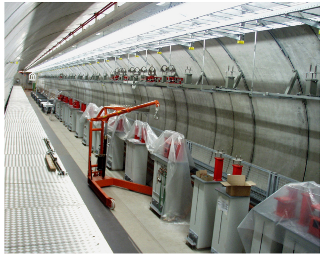
Abbildung 152: Blick in den TTF2-Tunnel mit Strahlführungsunterbauten.
