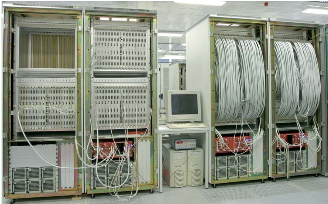
Abbildung 168: Aufbau des apeNext-Systems im Rechenzentrum Zeuthen.
