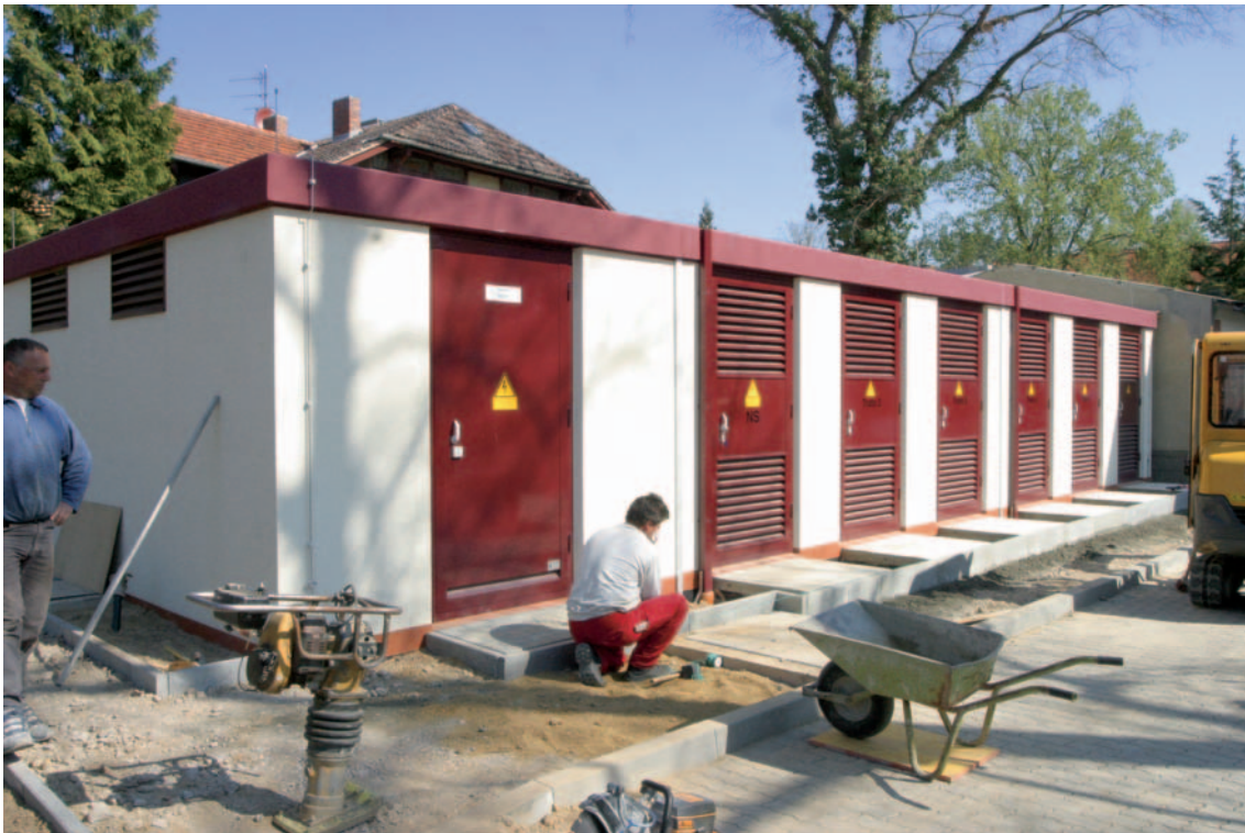
Abbildung 145: Die neue Stromeinspeisung mit 20 kV Station.
