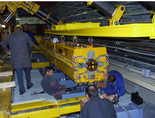
Abbildung 133: Einbau der Quadrupolmagnete Typ GN.
