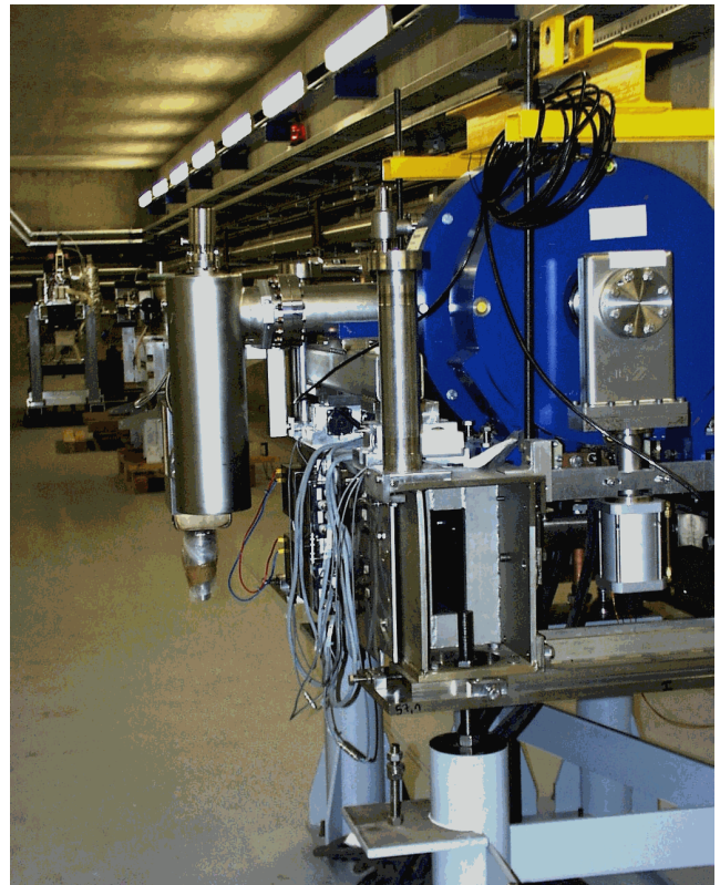
Abbildung 98: Im Vordergrund ist das Gestell des Hochfrequenz-Resonators mit den umgebenden Magneten im neuen Beschleunigtunnel gezeigt. Im Hintergrund sind Teile des Kathodensystems und des Diagnose-Gestells zu erkennen.
