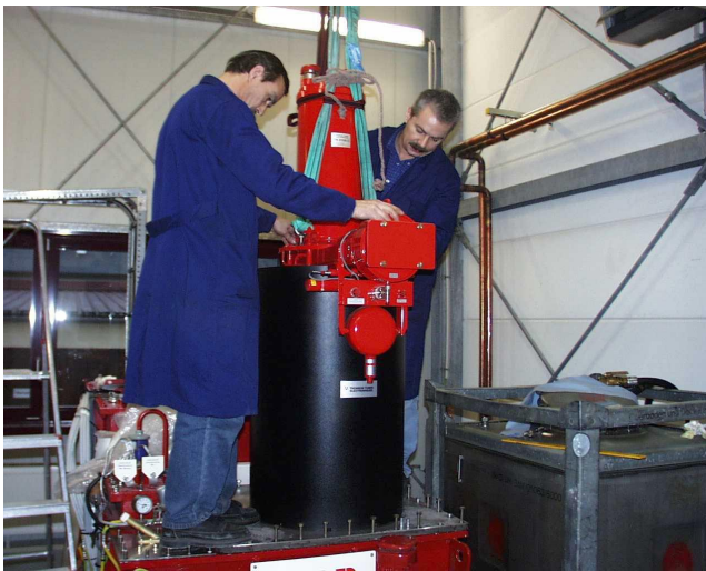
Abbildung 99: Installation eines 5 MW Klystrons für PITZ.
