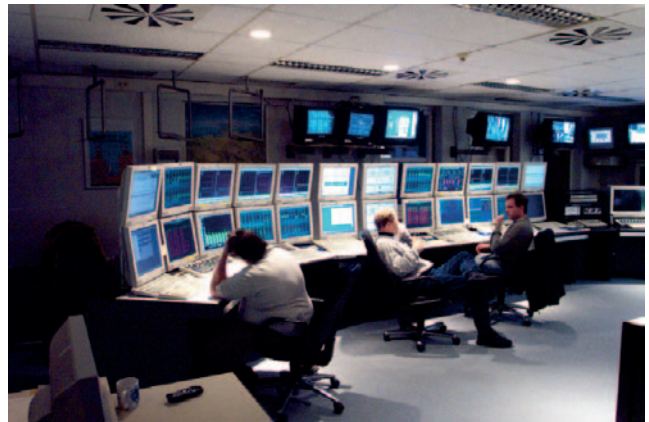
Abbildung 114: Bedienkonsolen des Kontrollsystems der HERA-Kälteanlage.
