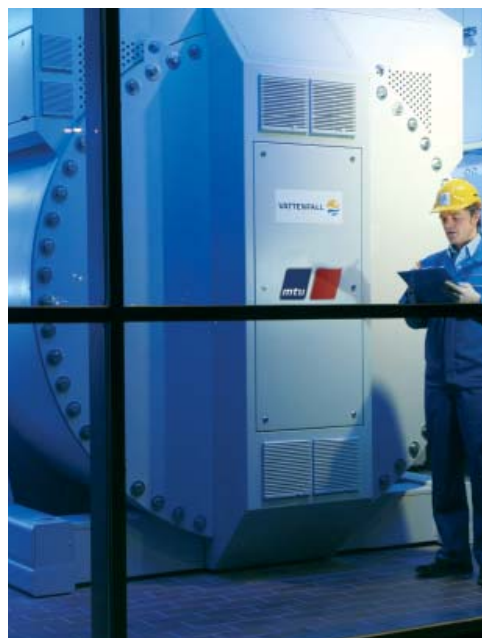
Zukunftstechnologie im Heizwerk: Eine Brennstoffzelle versorgt die Hafencity umweltfreundlich mit Strom und Wärme
