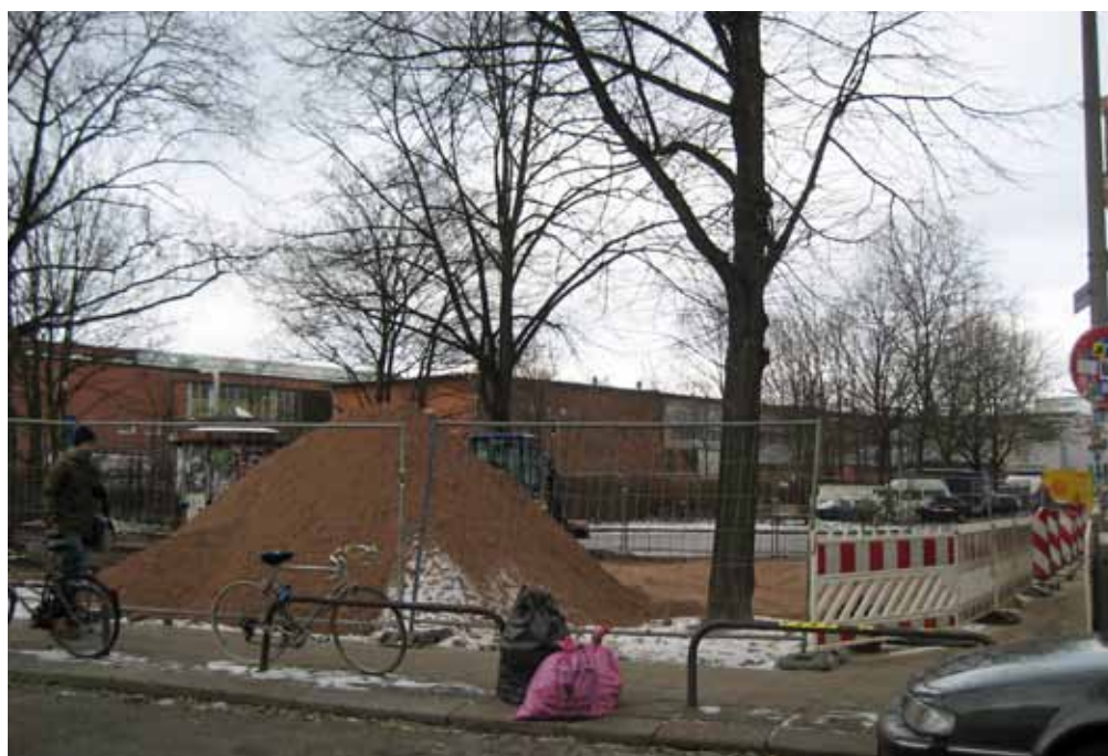
Die Umbauarbeiten haben begonnen. Der Fortgang ist allerdings abhängig von der Witterung.
