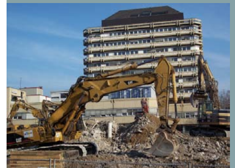
Abriss für den Neubau der Endo-Klinik. Im Hintergrund der Altbau, der anschließend saniert wird.
