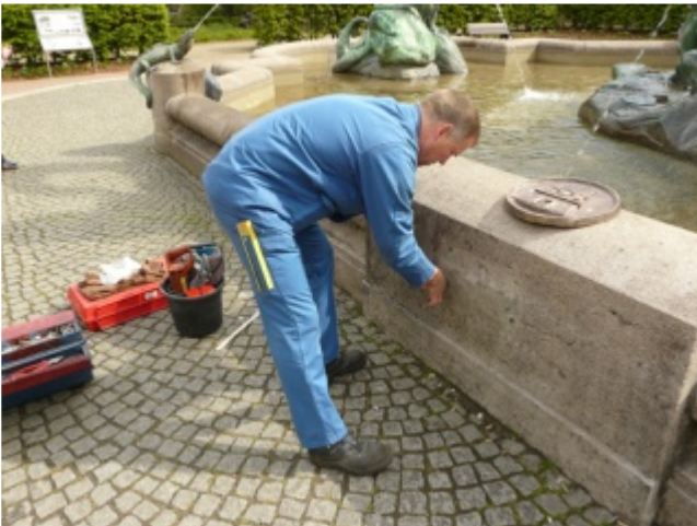
Die alten Bohrlöcher bereiten Sorgen
