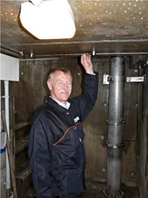
Herr Trawka prüft und vermisst die stark angerostete Hydraulikleitung an der tropfnassen Betondecke des Stuhlmann-Brunnen-Kellers...
