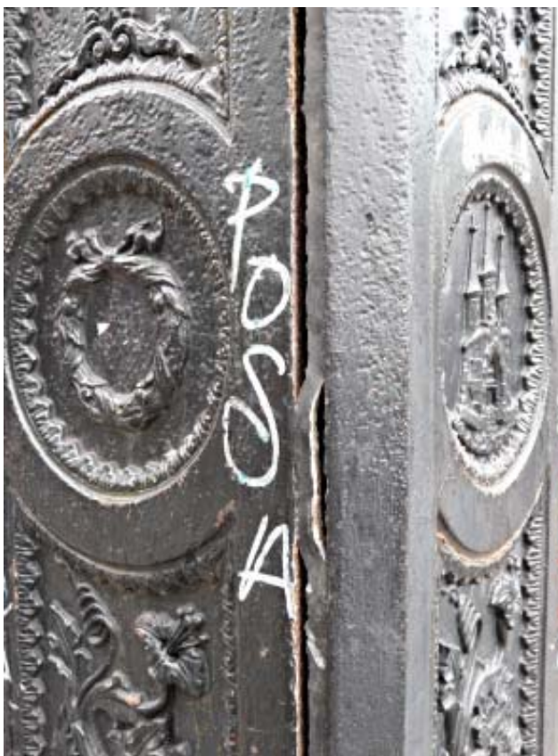
Tiefe Risse in der Mitte...
