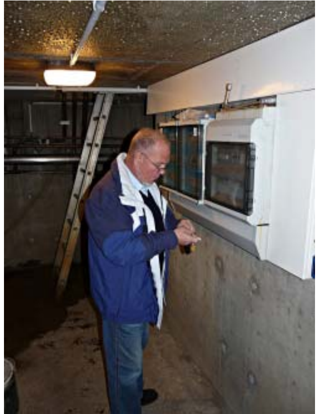
Herr Seiler versucht hier erfolgreich, den elektrischen Verteilerkasten der Brunnenanlage zu öffnen...
