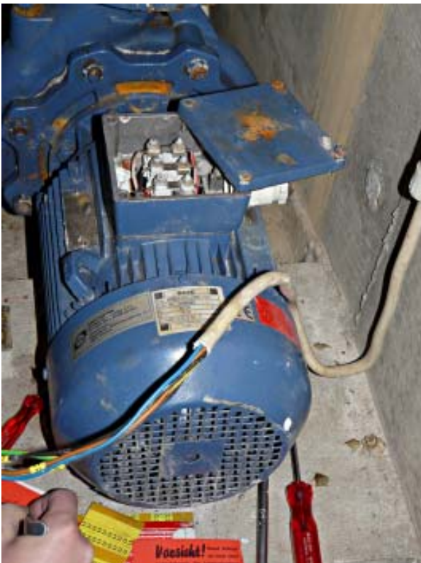
Die defekte Pumpe...
