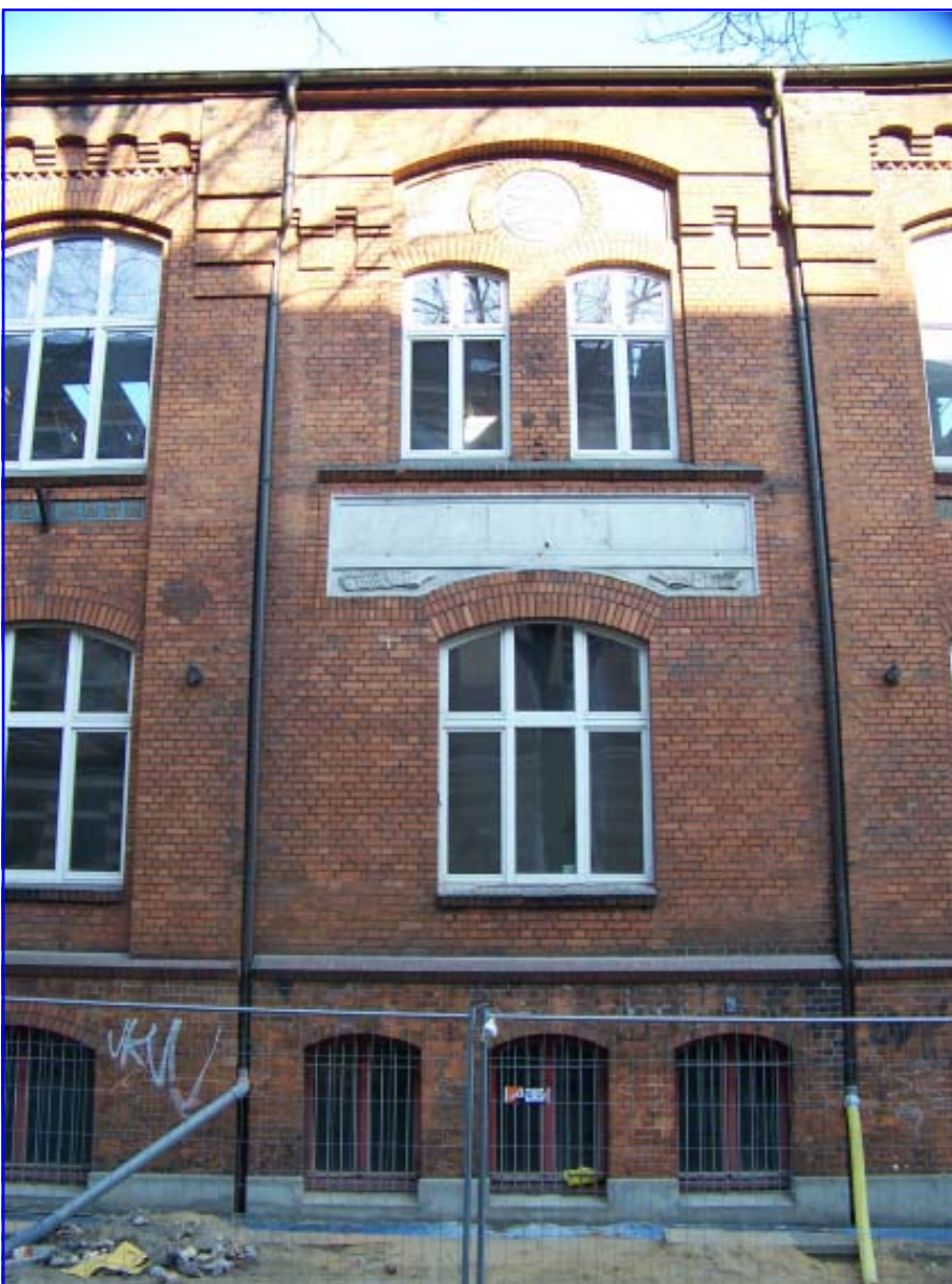
Die eingezäunte Fassade des ehemaligen „Guttempler-Hauses“ im April 2008
