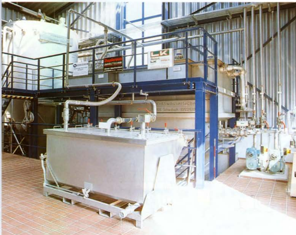
Abb.5.3 Leichtstoffabscheider, im Vordergrund der Entwässerungscontainer
