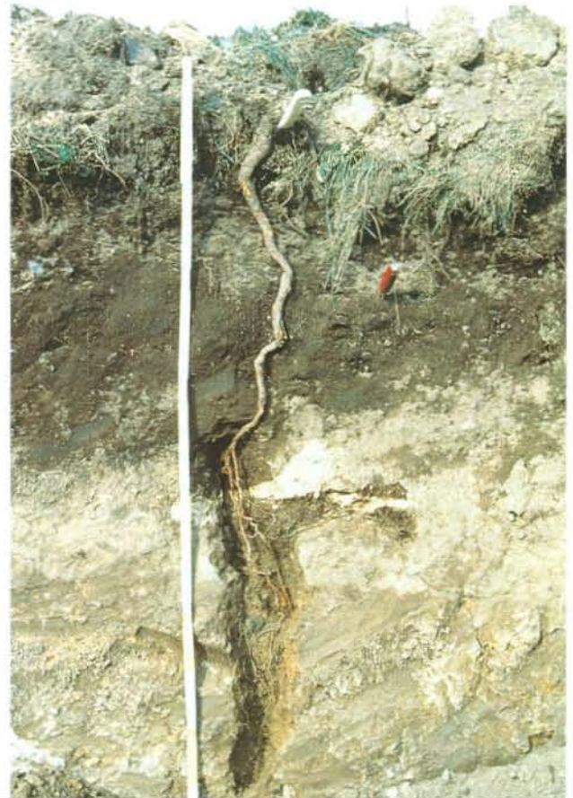
Abb.3.8 Ampfer-Wurzel in der Oberen Abdeckung, bis in 140cm Tiefe freigelegt
