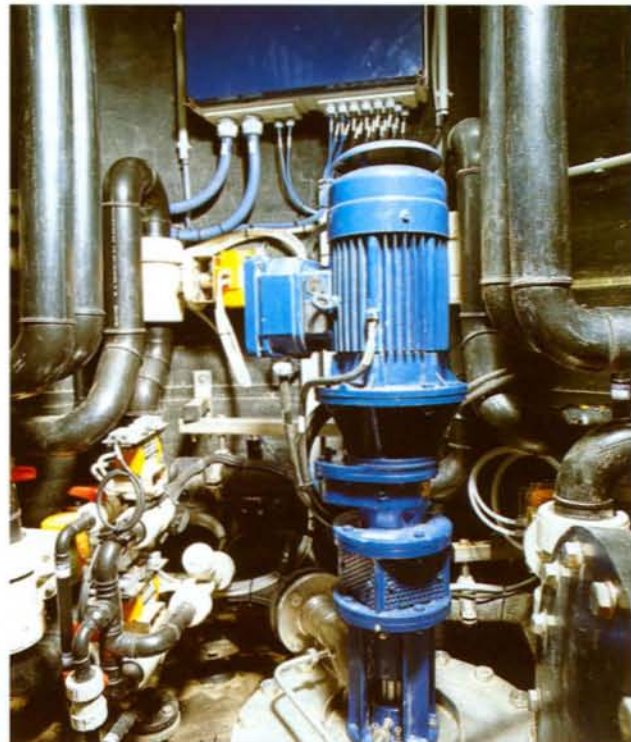
Abb.5.1 Exzenterschneckenpumpe im Schacht
