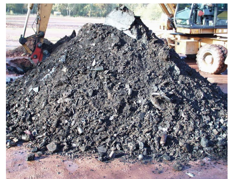
Müllhaltige Auffüllung aus der Deponie (Quelle: BBI Geo- und Umwelttechnik)
