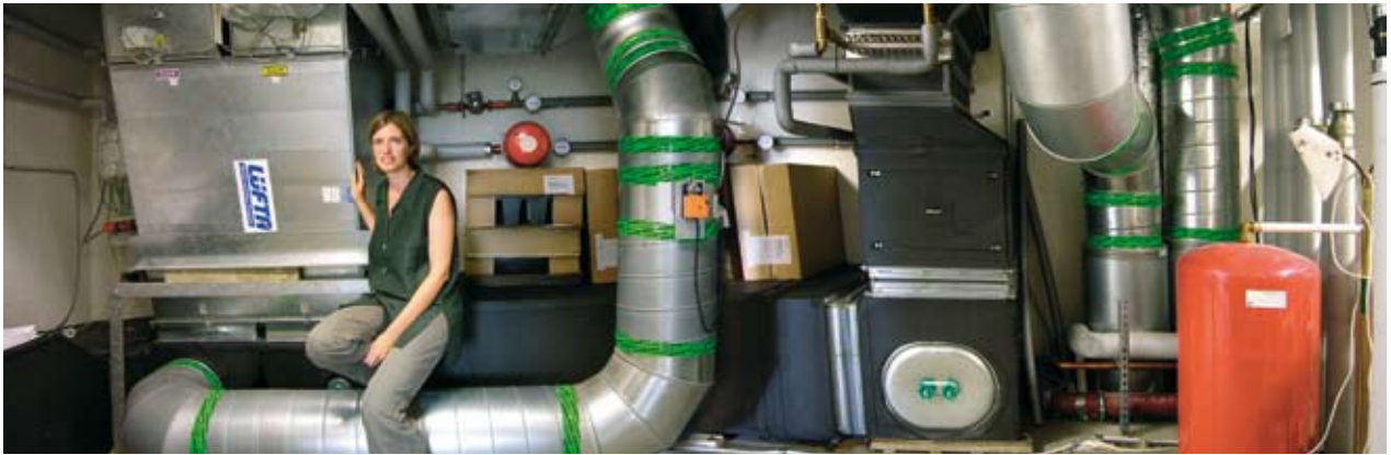
Die Lüftungsanlage mit Wärmerückgewinnung (ganz links) sorgt automatisch und kontinuierlich für frische Luft
