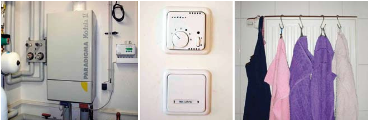
Zentrale Gastherme für 60 Personen; Zimmer-Thermostat für Raumtemperatur; Badezimmerheizkörper
