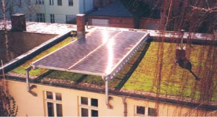
Dachparallel montierte Vakuumröhrenkollektoren
