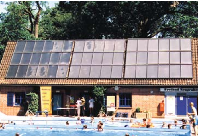
Kollektoranlage zur Erwärmung des Schwimmbadwassers in Hamburg - Neuwiedenthal
