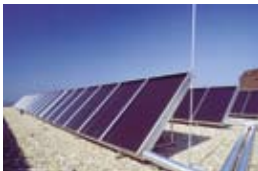
Auf Flachdach aufgeständerte Flachkollektoren
