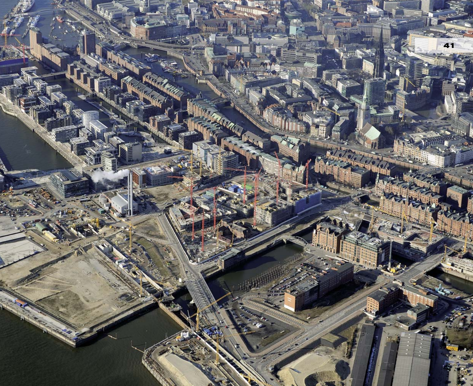
Die Umstrukturierung ehemaliger Hafengebiete erfordert einen komplexen Infrastrukturausbau. Im Zentrum die U-Bahn-Baustelle der U4 mit der offenen Bauweise durch den Magdeburger Hafen nach Osten
