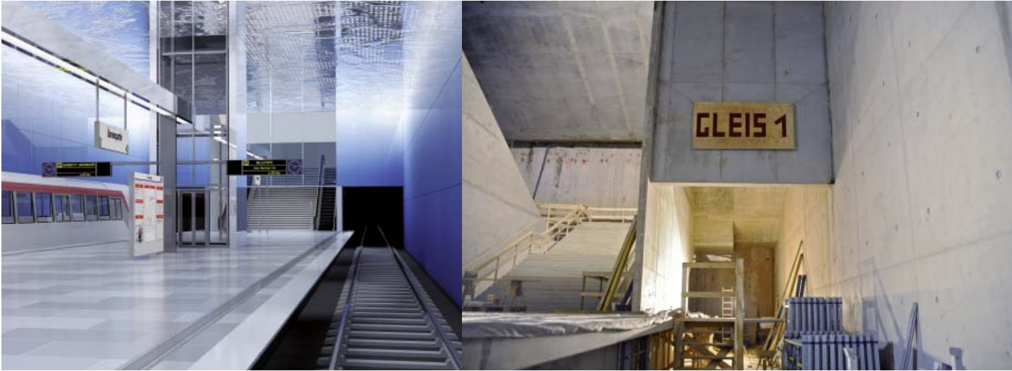
Mit zwei Haltestellen der neuen U4 wird die HafenCity ans Nahverkehrsnetz angeschlossen. Die Station Überseequartier ist im Januar 2009 im Rohbau fertiggestellt worden; jetzt folgt der Technikausbau
