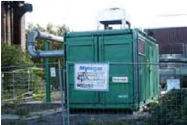
1 Stromerzeugung aus Minogas, Dortmund, früher Schacht „Minister Stein“ Power generator using black damp, Dortmund, former mine “Minister Stein”
