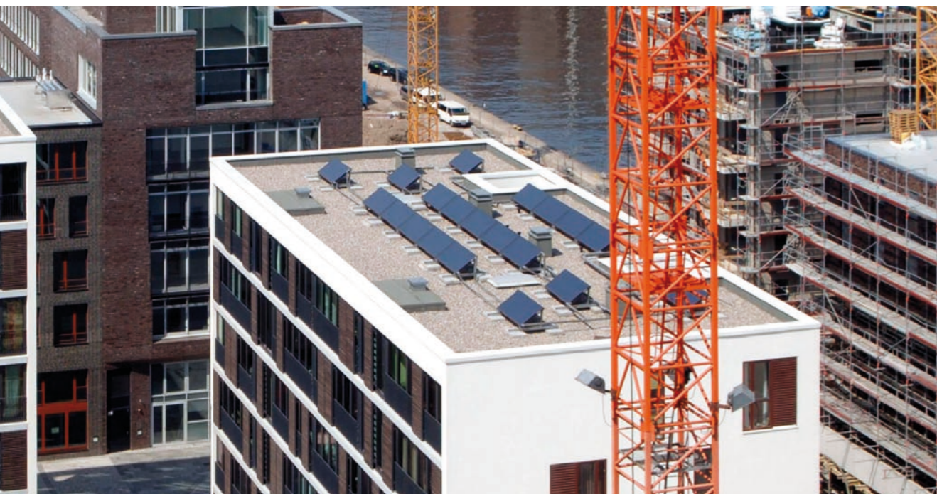
Solarthermische Anlagen auf dem Wohngebäude der Baugenossenschaft Bergedorf-Bille
