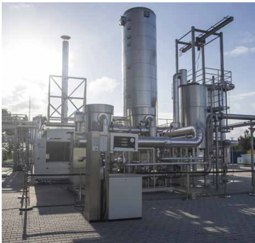
Unter Federführung der AUDI AG wurde im niedersächsischen Verthe die weltweit erste Power-to-Gas-Anlage in industriellem Maßstab zur Erzeugung von synthetischem Erdgas errichtet.
