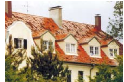
Hagelschaden an einem Ziegeldach
