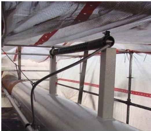
Abb. 19: Mischoxid beschichtete Titananode im gelochten PE-Schutzrohr, Quelle: HOCHTIEF
