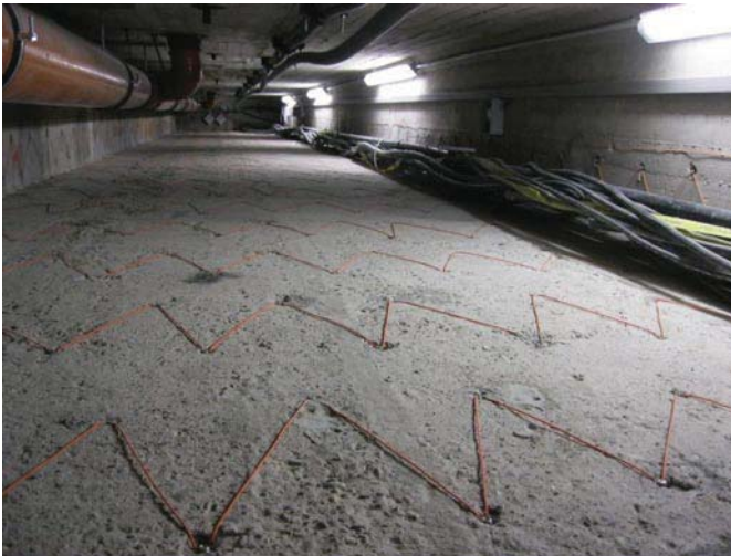
Abb. 6: Anodenverkabelung im Hohlkasten
