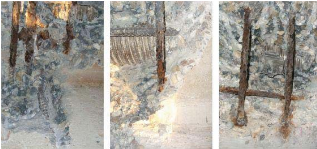
Abb. 2: Korrosionsschäden mit starker Querschnittsminderung; Hüllrohre in Ordnung
