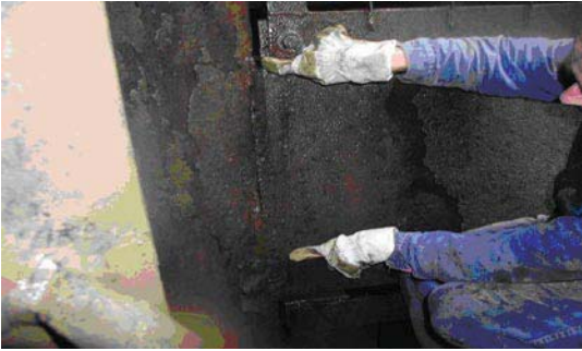
Bild 2: gerissener Druckgurt eines Hauptträgers
