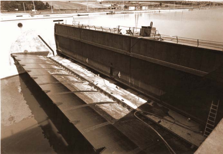
Abbildung 4: Wehr Ottendorf - Fischbauchklappe abgelegt mit schwimmenden Oberwasser-Revisionsverschluss
