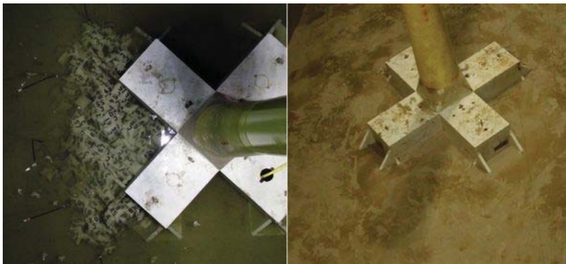
Abbildung 4: Fundament während der Einbauphase des Kolkschutzsystems (links) und Fundament mit fertig eingebautem Kolkschutzsystem im Anfangszustand im GWK (rechts)
