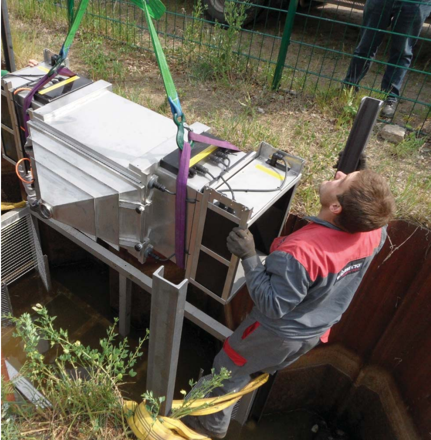
Abbildung 2: Einbau eines automatischen Fischzählsystems
