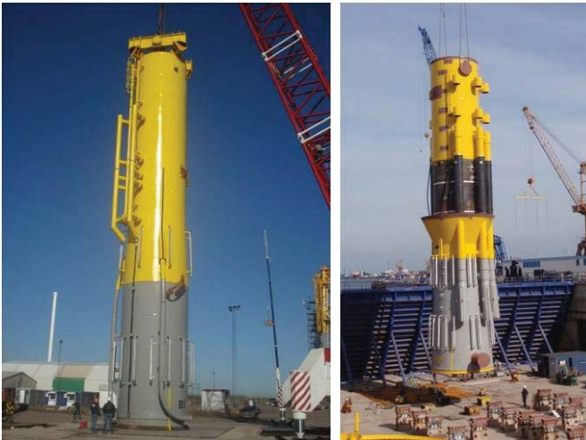
Abb. 26 + 27: TP WEA, TP Umspannplattform
